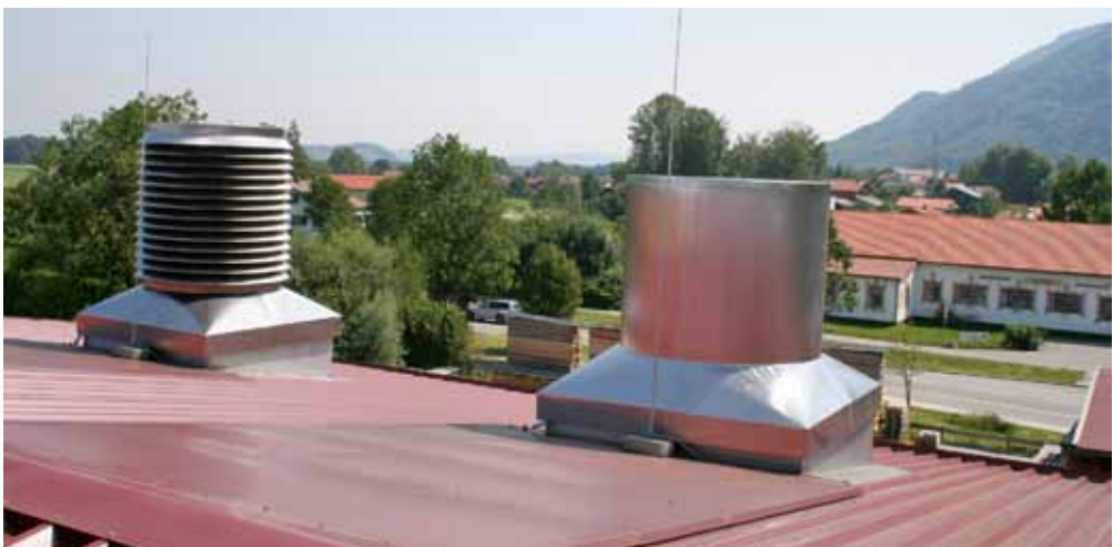
Abb. 5: Ansaugung von Außenluft über Außenlufttürme auf einem Gebäudedach (links)
