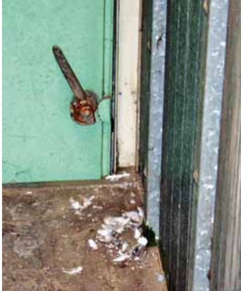
Abb. 6: So grausam kann es unmittelbar hinter einer Außenluft-Ansaugklappe aussehen, wenn man die regelmäßige Wartung vernachlässigt – Lufthygiene ade!
