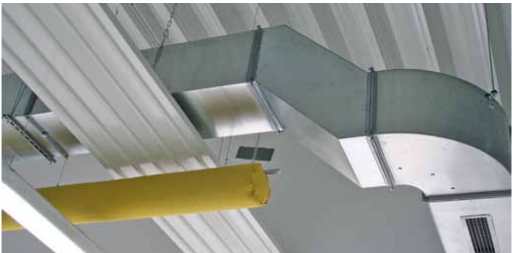
Abb. 14: Zulufteinbringung in einen Raum über einen Luftschlauch
