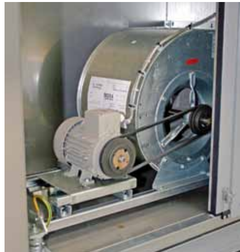
Abb. 10b: Ein Ventilator in einem RLT-Gerät als riemengetriebener Ventilator
